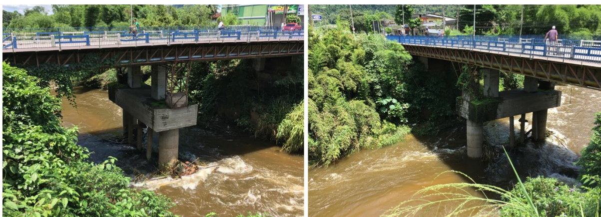
Figura 1 - Fundações expostas de ponte sobre o Rio Guapimirim (Fotos – Toiz Vidaurre)
